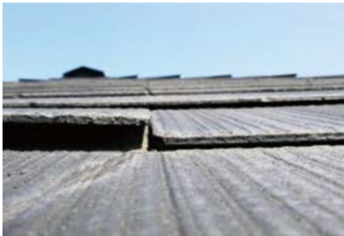
▼ コロニアルの浮き
