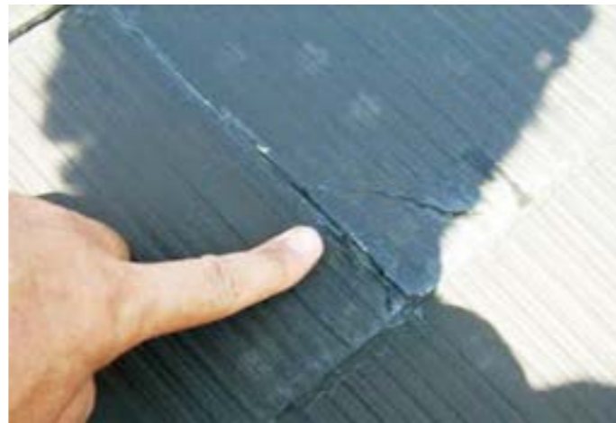
▼ コロニアルの割れ
