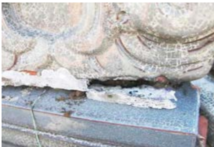
▼ 漆喰の剥がれ
